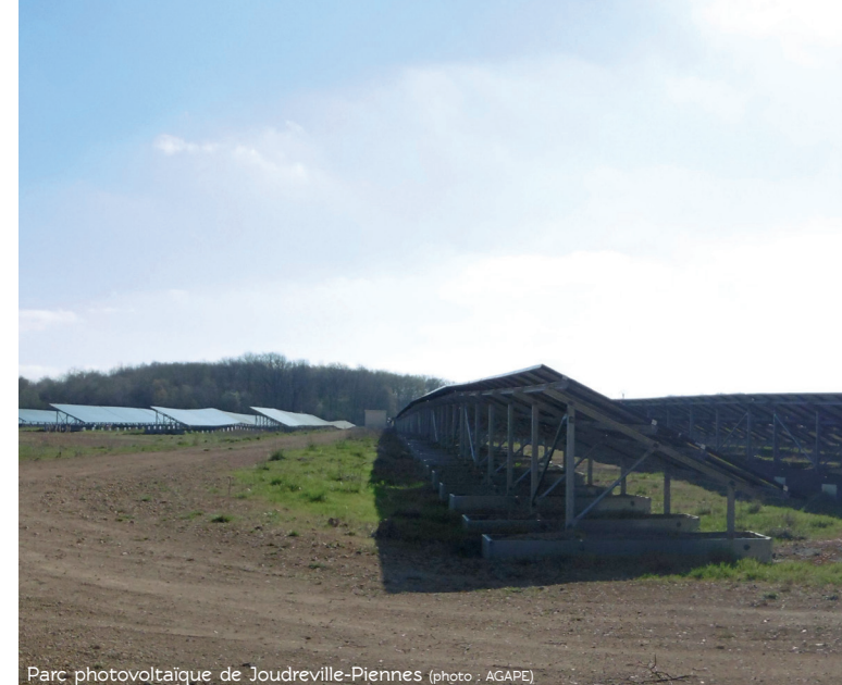
Parc photovoltaïque de Joudreville-Piennes (photo : AGAPE)
